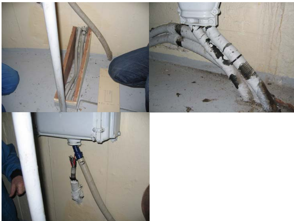
Øverst til venstre: Styre- og strømkabler til hydraulik. Øverst til højre: Styrekabel til styring af broens åbne-/lukkefunktion (i boks) samt strømforsyningskabel. Nederst: Styrekabler til bomme, blinklys m.v.
